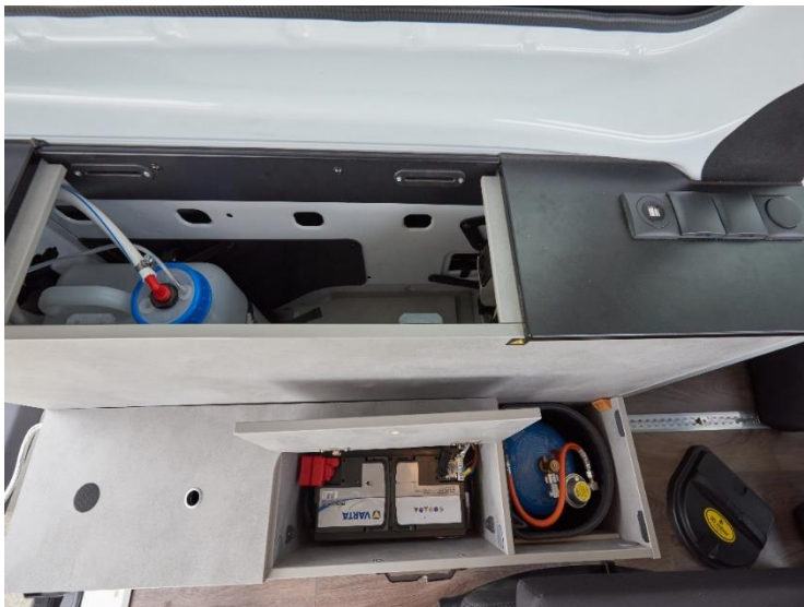
Die Installationen für Wasser, Gas und Strom nehmen den Stauraum links im Heck ein. (Quelle: ADAC/Uwe Rattay)
